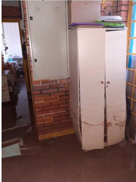
Foto 57. QGBT – águas, aparentemente, não o atingiram
