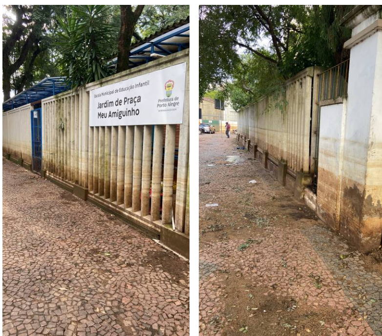
Fotos 03 e 04. Cercas da escola – Gradis de concreto atingidos pela enchente.
