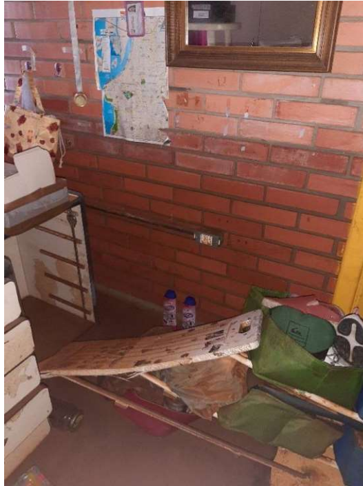
Foto 62. Eletrodutos e tomadas baixas molhadas, deverão ser substituídas
