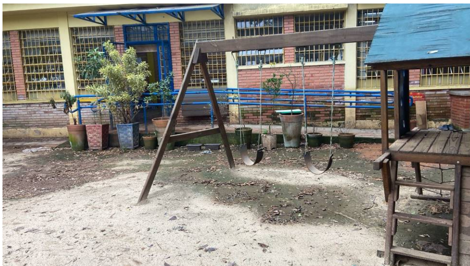
Foto 48. Fundos da Escola – guarda corpos da acessibilidade avariados.
