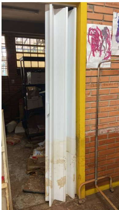
Fotos 12 Porta Sanfonada de PVC avariada.
