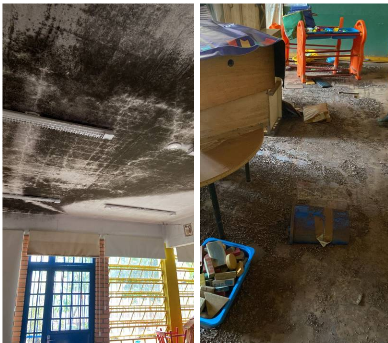
Fotos 24 e 25. Interior da Escola - paredes, pisos e tetos avariados pela enchente.
