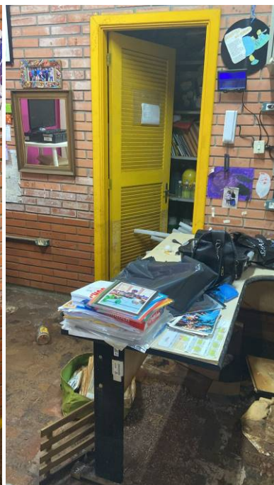
Fotos 13 Porta de madeira com veneziana, piso e paredes avariados.
