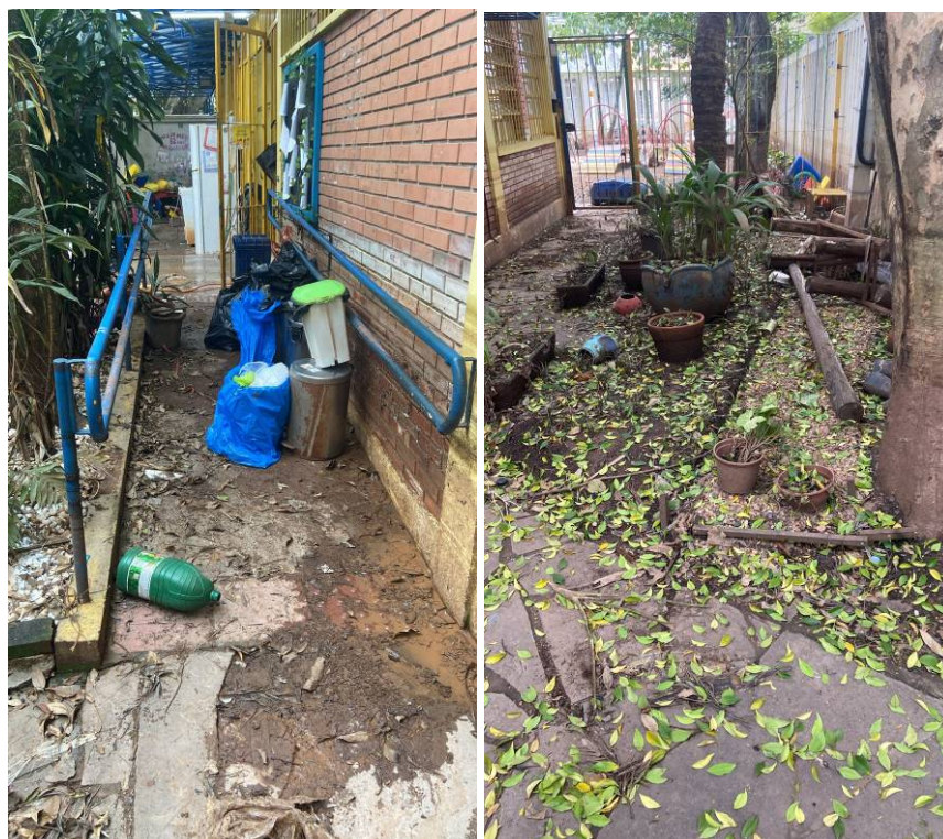
Foto 49. Frente da Escola – piso e guarda corpos da acessibilidade avariados.
