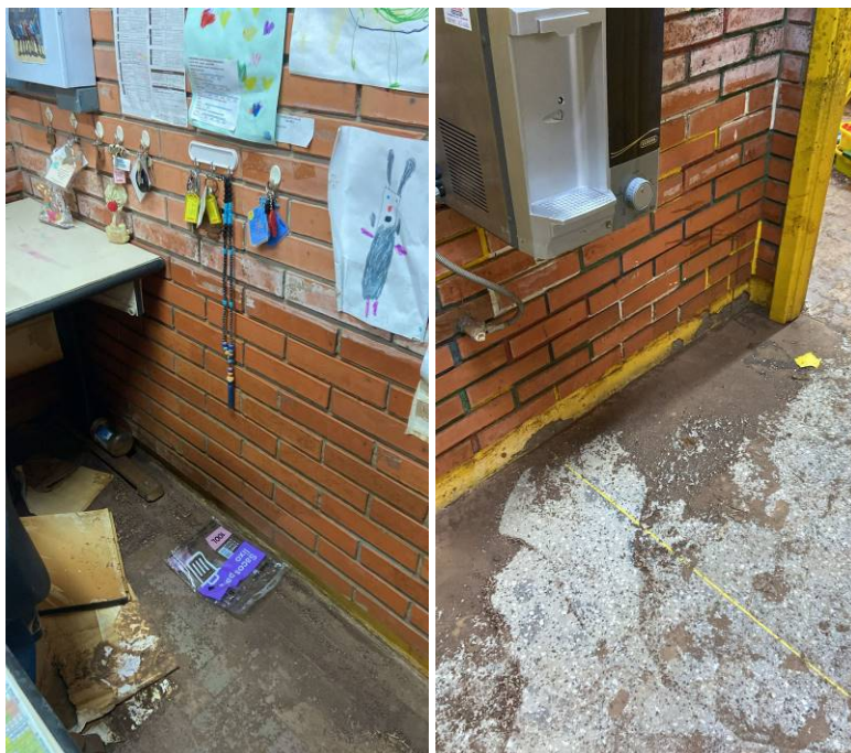
Fotos 26 e 27. Interior da Escola - paredes e pisos avariados pela enchente.
