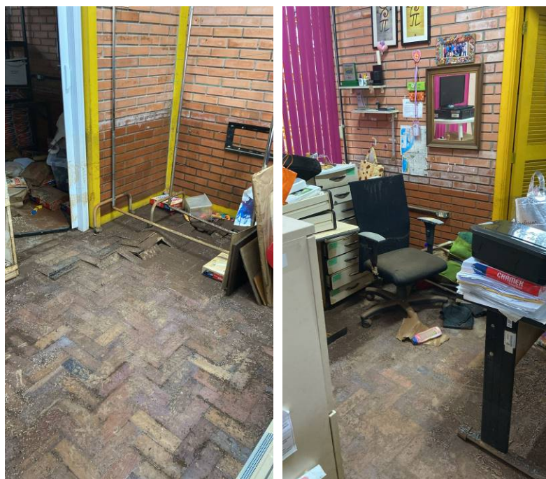
Fotos 34 e 35. Interior da Escola - paredes, pisos e móveis avariados pela enchente
